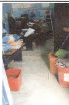
Foto 5: Sustrucción de piso de granito.
